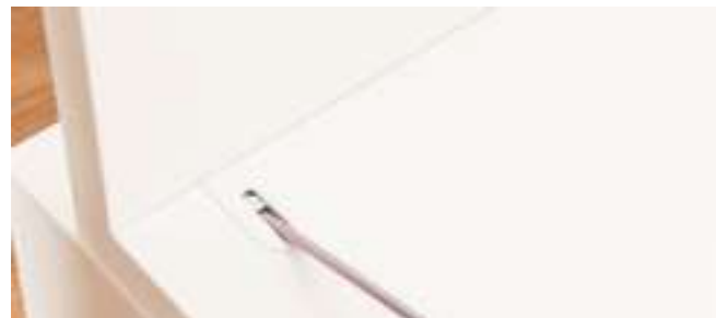
Unir los elementos del mueble con atornillador a batería y una herramienta Cabineo. El trabajo es fácil y rápido gracias a un par de apriete predefinido de aprox. 2.5 Nm.
